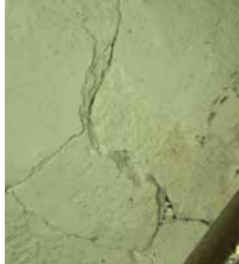
Bobin Sıvası Çatlakları
