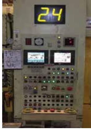
Main Operatör Paneli
