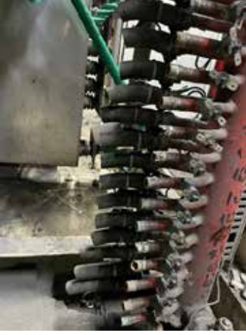
Manifold Nozzle Hasarları
