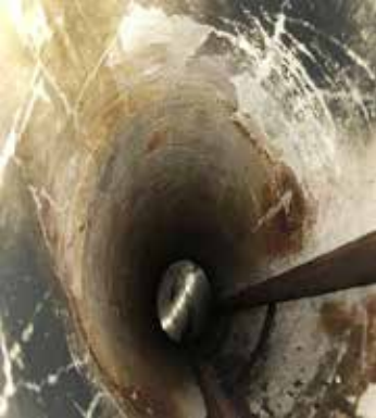
Bobin Sıvası Çatlakları
